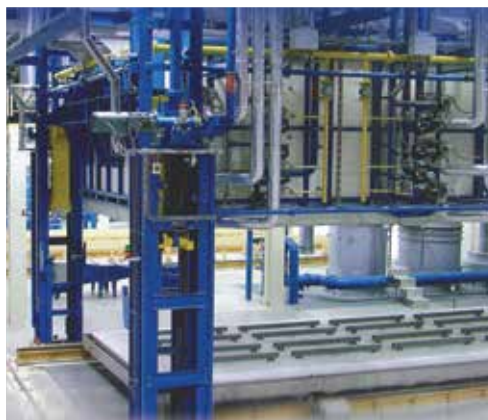
Haubenofenanlage der Firma CTB, zugestellt u. a. mit Altra-Modulen
