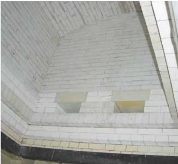
Haube eines Bickley-Ofens zugestellt mit Hohlkugelkorundsteinen
